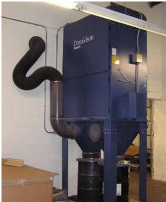
UMA 450 - Filtración de plástico de unamáquina CNC
