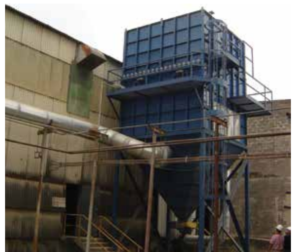
324MBWS10 en una Instalación de Manufactura de Tejas de Arena
