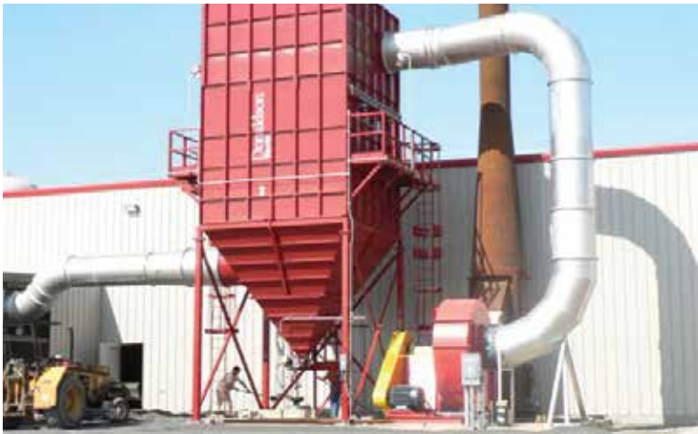
324MBWS10 en Instalación de Manufactura de Vidrio
