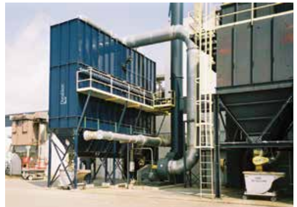
405MBW10 en una Fundidora
