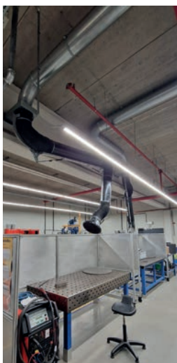
Brazos de extracción conectados a una unidad central de filtración.
