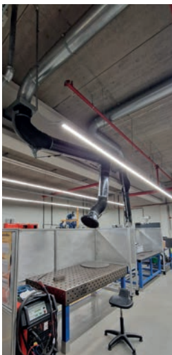
Absaugarme, verbunden mit einer zentralen Filtrationseinheit.
