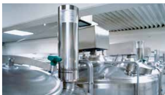
Carcasas de filtros para el venteo de tanques de almacenamiento
