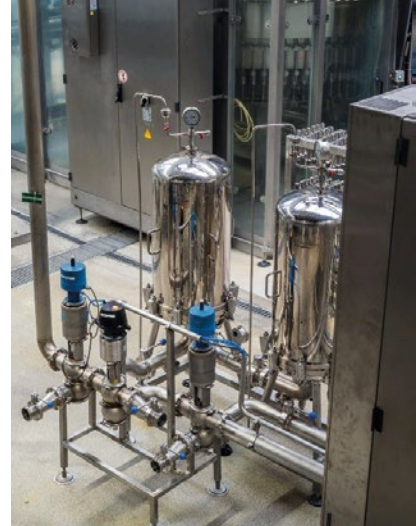
Mineralwasserfiltration an der Abfüll-anlage Linie 5 für Mineralwasser mengen von bis zu 30 m³/h.
